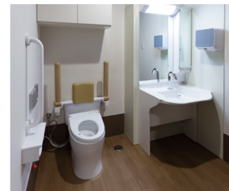
安全に配慮した水回り
